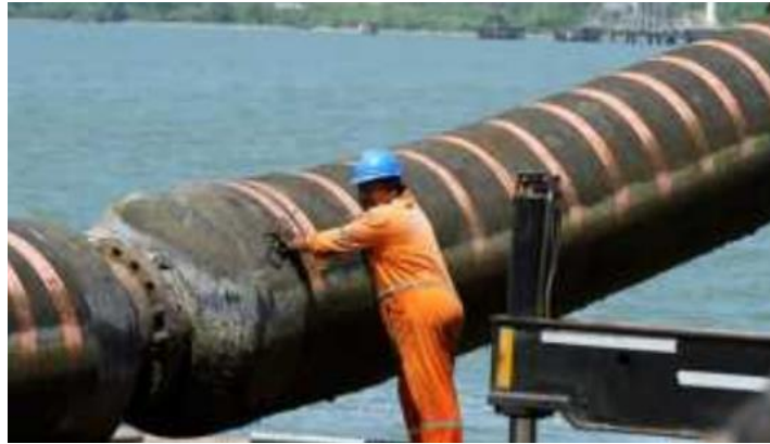
Gambar 9 Kebocoran pipa bawah laut
