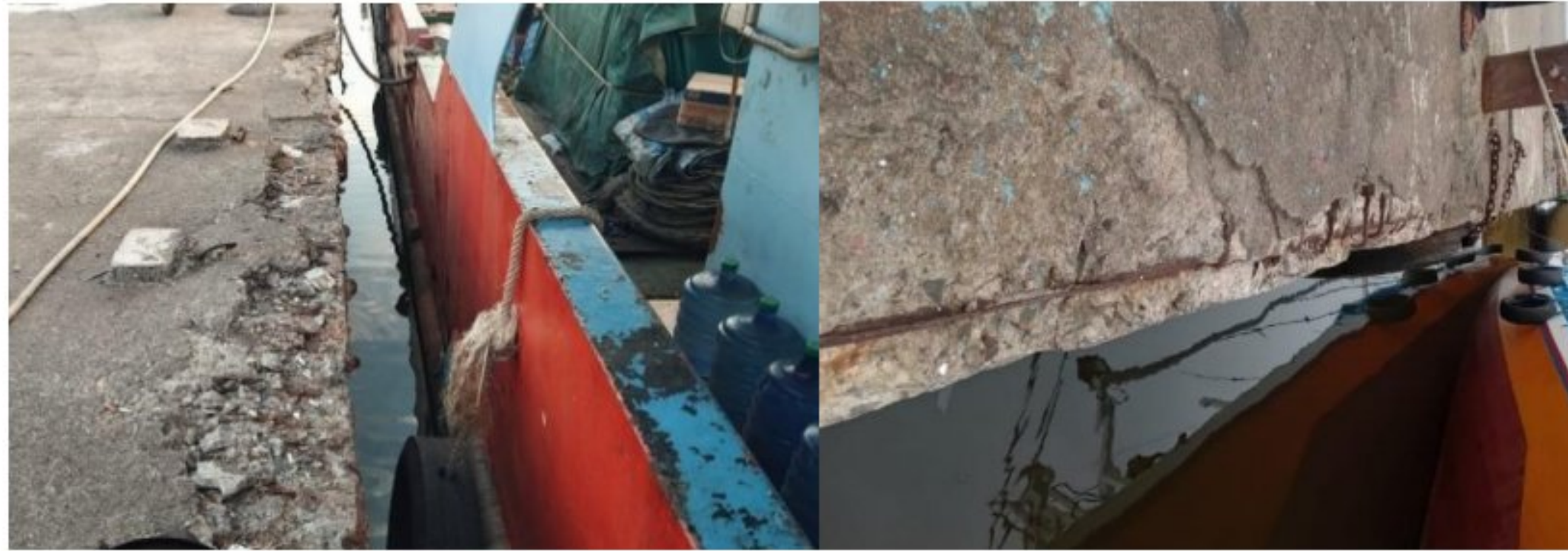
Gambar 1.1. Kondisi dermaga di Pelabuhan Paotere
