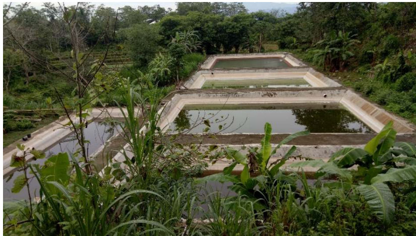
Gambar 6. Bak Penampungan, Sumur, dan Kolam Lindi
