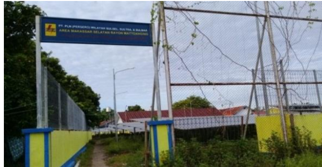
Gambar 5.5 Pembangkit Listrik Tenaga Surya. Sumber: Dokumentasi Pribadi
