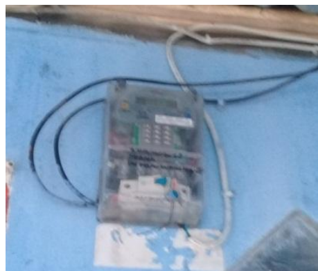
Gambar 5.6 Meteran Listrik Pintar. Sumber: Dokumentasi Pribadi.
