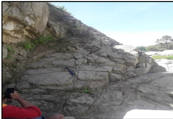
Gambar 2.2 Retakan pada litologi granit yang menunjukkan terjadinya pelapukan fisika pada stasiun 10 dengan arah foto N 152° E
