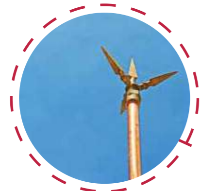
Penempatan sistem penangkal petir franklin pada bagian teratas atap bangunan
