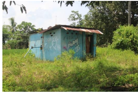
Instalasi Pompa Air
