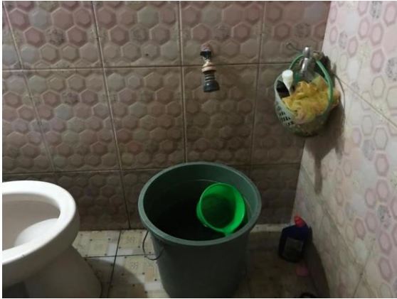
Penampungan air tanpa penutup
