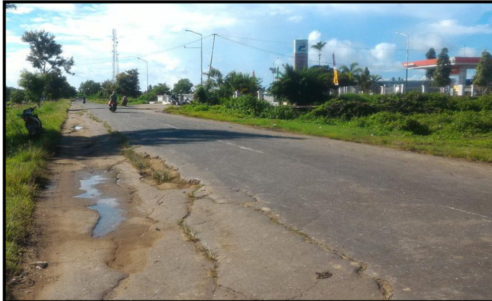
Gambar 4 Ruas Jalan Kuprik - Semangga, Kampung Kuper
