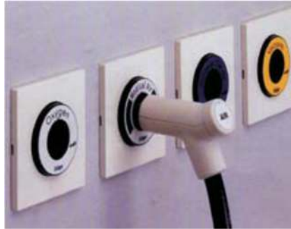
Gambar 3. Instalasi oksigen sentral
