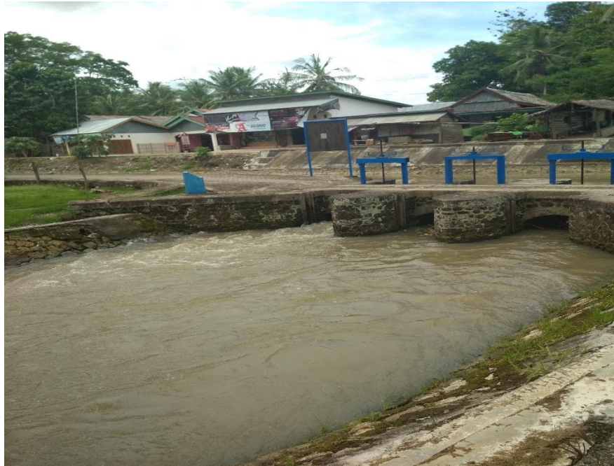
Gambar 3. Pembatas Saluran Sekunder Irigasi Bendung Pattiro
