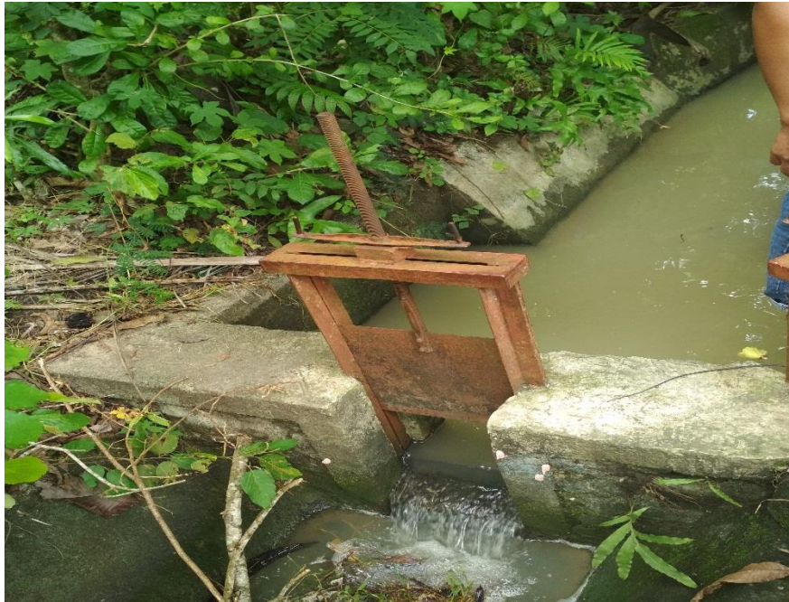
Gambar 7. Pintu Pembatas Boks Bagi
