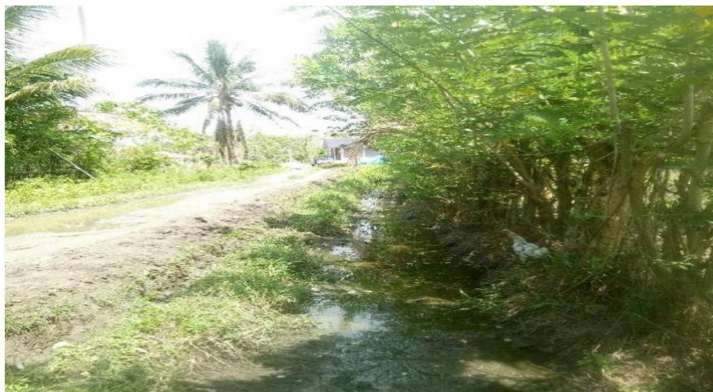
Gambar 8.3 : Kondisi Drainase yang tidak berfungsi
