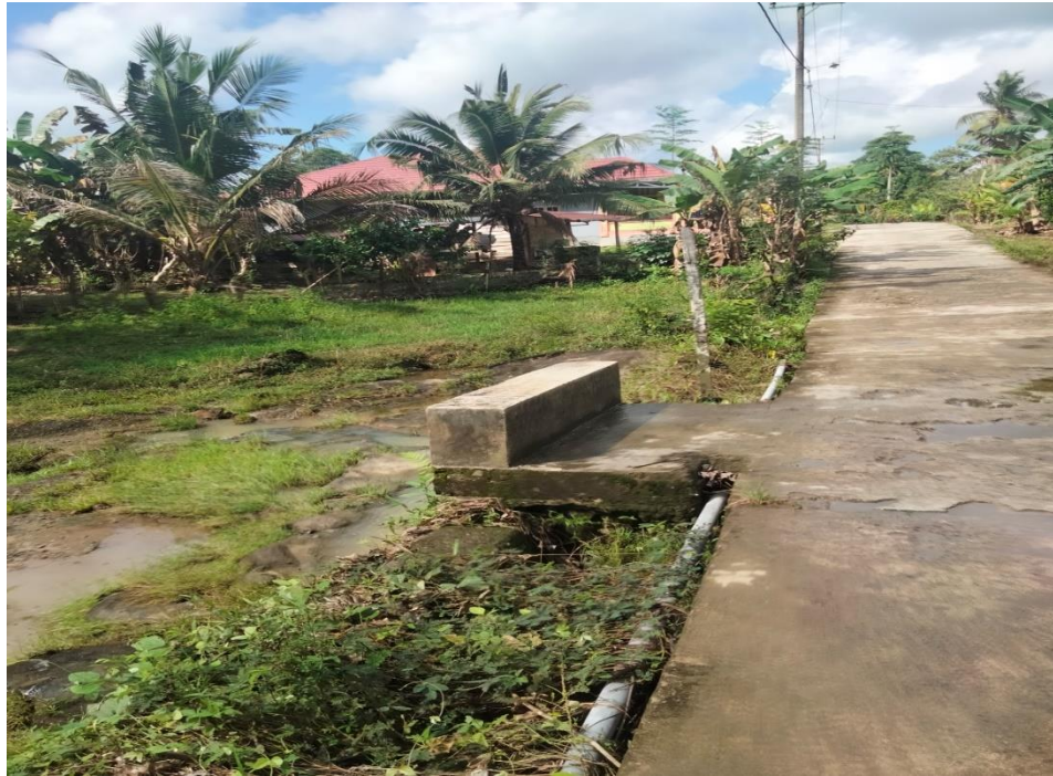
Kondisi Jalan Di desa Botto Mallangga
