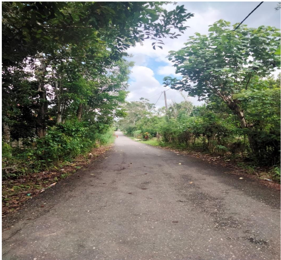
Kondisi Jalan Di Desa Botto Mallangga
