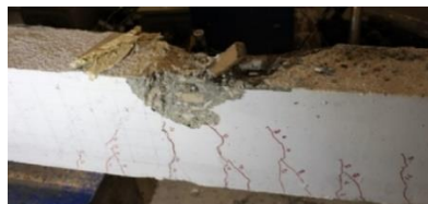
(b) Pola retak pada kegagalan balok R-75-R
