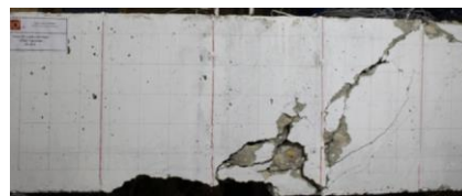
(d) Pola retak pada kegagalan balok R-NSM-4L 90
