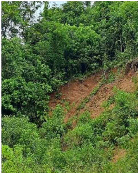
Tanah Longsor 3, dikelilingi oleh penutupan lahan hutan sekunder dan akses yang masih bisa ditempuh
