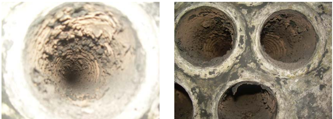
Gambar 6. Fouling di dalam pipa api
