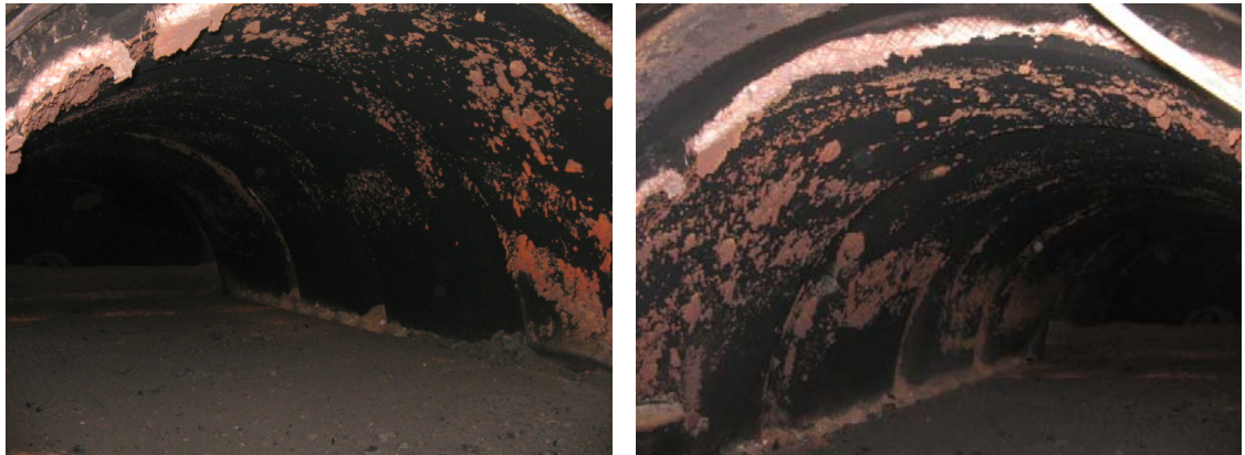
Gambar 5 Slagging pada ruang bakar
