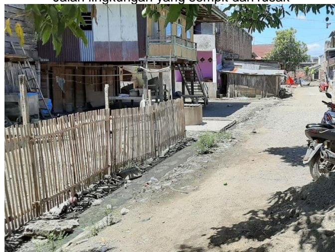
Jaringan drainase yang rusak, kotor, bau, bercampur dengan limbah rumah tangga
