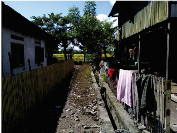
Jalan lingkungan yang sempit dan rusak
