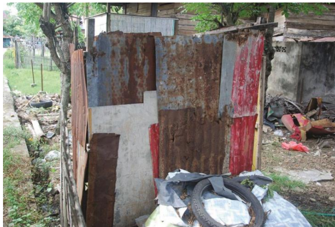
Bangunan Jamban/MCK Komunal rusak
