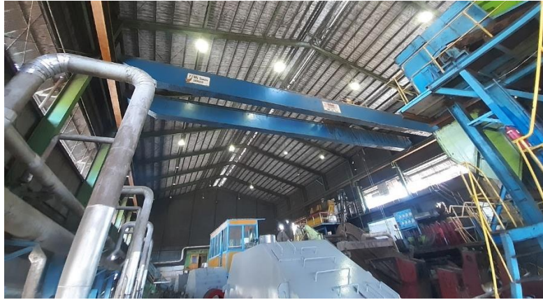
Lampiran 11 : Dokumentasi crane di PT. Perkebunan Nusantara XIV PG Takalar
