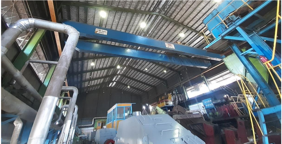
Gambar 2. 6 Overhead Travelling Crane SWL 20 ton yang terpasang di ruang penggilingan Pabrik Gula Takalar
