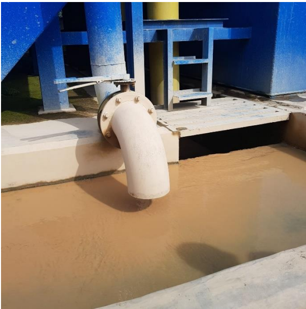
Pipa Pembuangan Lumpur Unit Filtrasi
