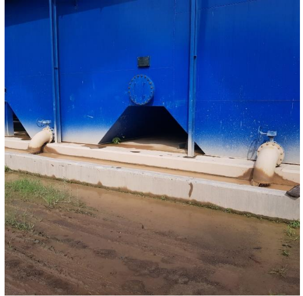
Pipa Pembuangan Lumpur Unit Sedimentasi
