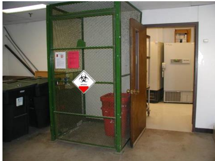
Gambar 1. Contoh fasilitas penyimpanan limbah B3 dari fasilitas pelayanan kesehatan dalam ruangan yang dilengkapi dengan pembatas akses(kerangkeng).
