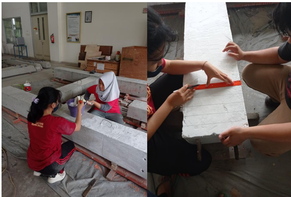
Pengecatan dan Penggambaran Grid Pola Retak
