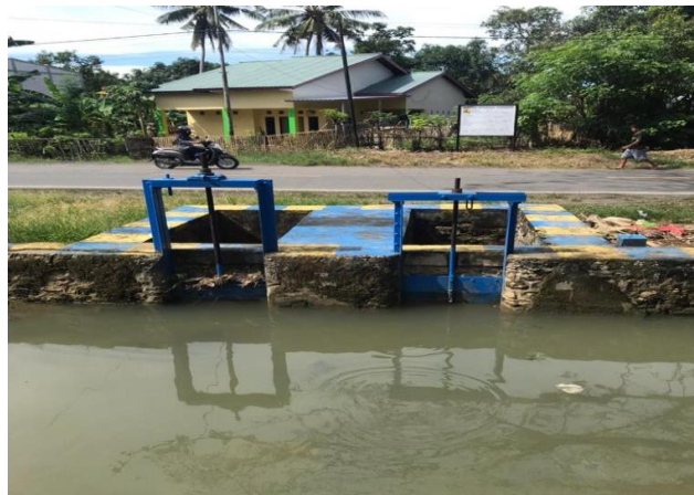
Gambar 7. Kondisi Pintu Air
