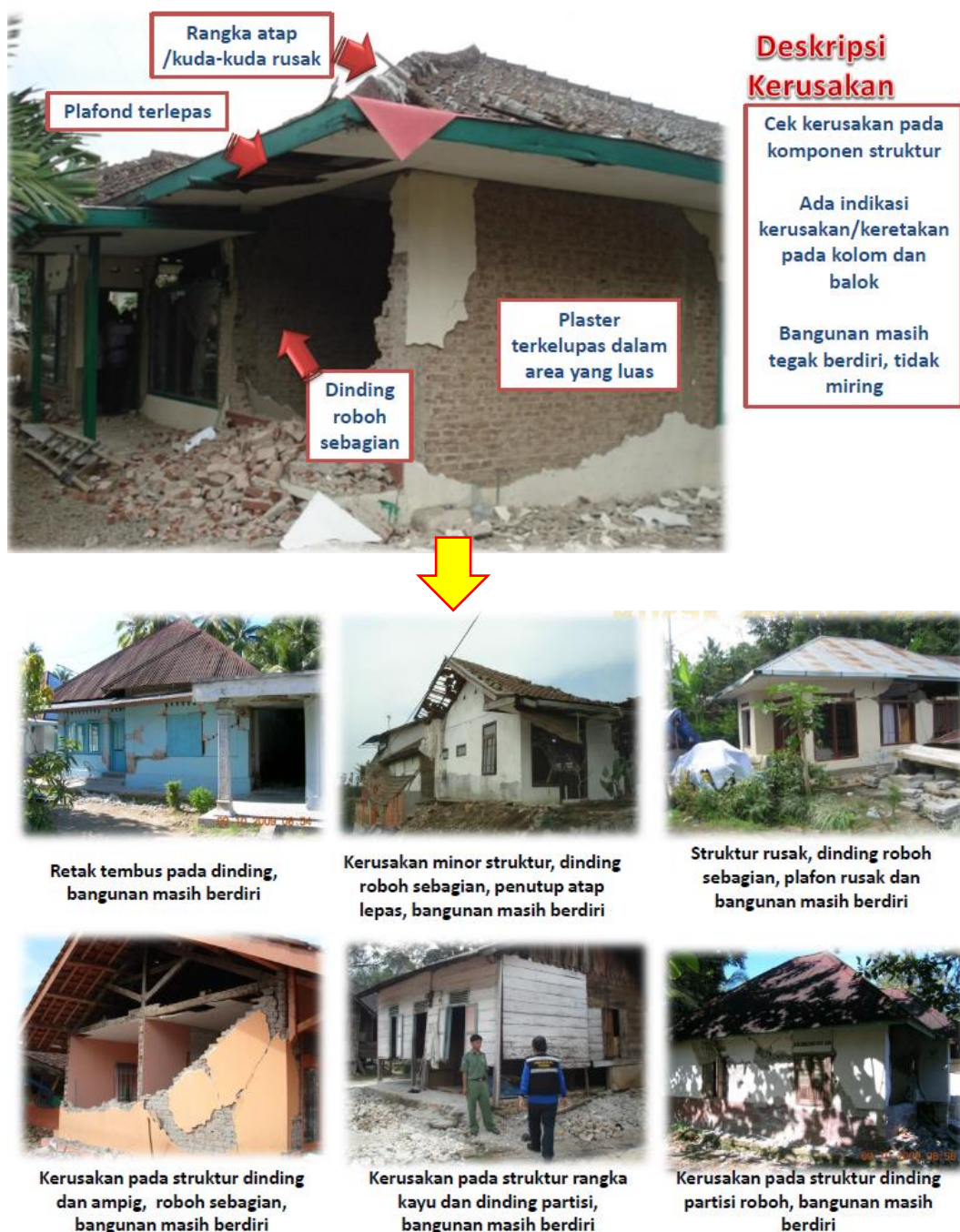
Gambar 4. Contoh kerusakan sedang yang terjadi akibat gempa bumi
