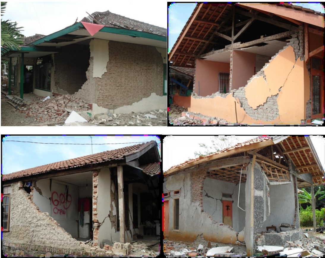
Gambar 1. Bangunan rangka beton bertulang dengan batu bata dari tanah liat yang dibakar sebagai dinding pengisi sangat rentan terhadap beban gempa
