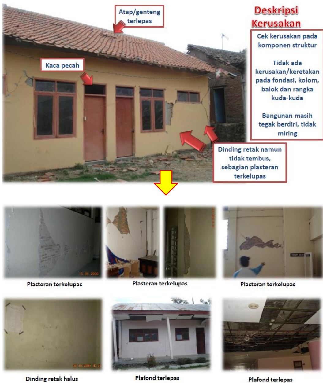
Gambar 3. Contoh kerusakan ringan yang terjadi akibat gempa bumi
