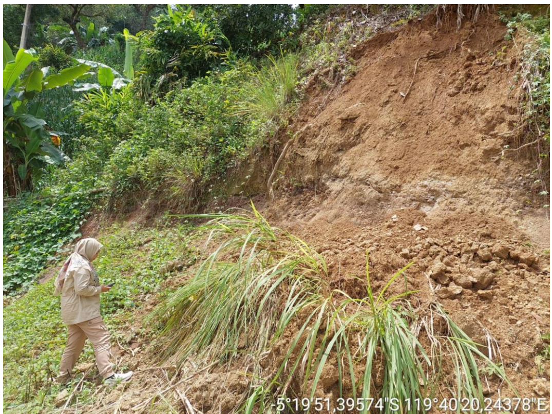
4. Dokumentasi Kejadian Longsor jenis pergerakan longsor translasi di Desa Mangempang Sub DAS Jenelata
