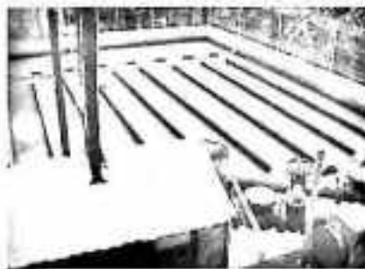
Bak Prasedimentasi dan Pompa Air Bak
