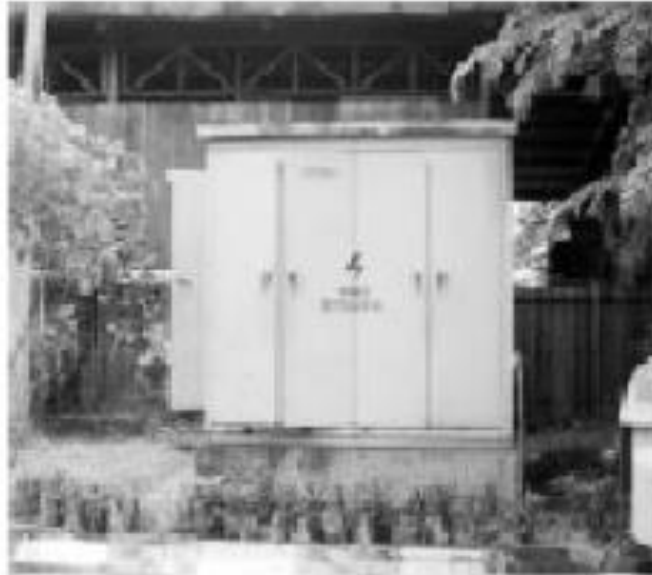
Gambar 2 11 Gardu Tipe Beton (PLN Buku 4, Standar Konstruksi Gardu Distribusi dan Gardu Hubung Tenaga Listrik, 2010)
