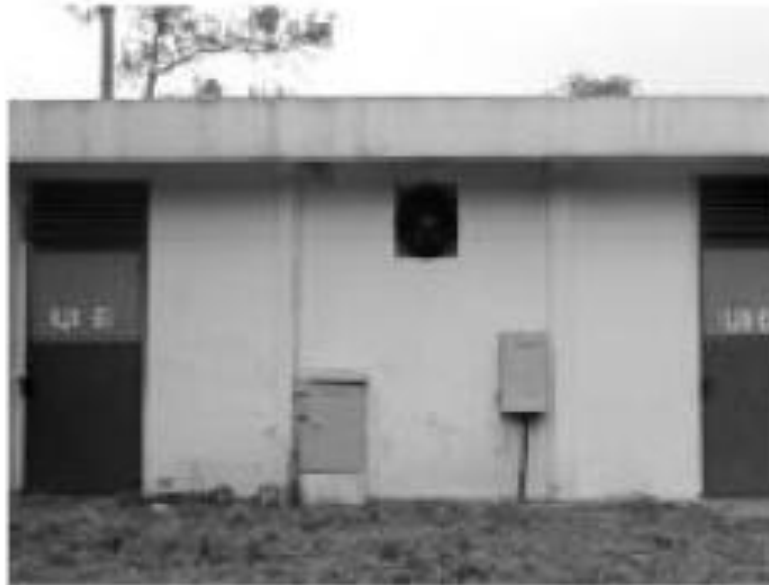
Gambar 2 7 Bangunan Gardu Beton (PLN Buku 4, 2010)
