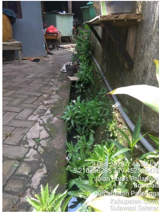
Gambar Kondisi Drainase pada RW 05 Sumber: Dokumentasi Penulis,2020
