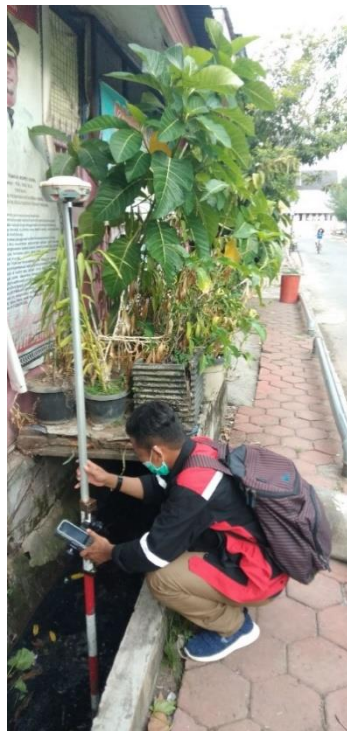
Gambar Kondisi Drainase pada RW 01 Depan Kelurahan Sumber: Dokumentasi Penulis,2020
