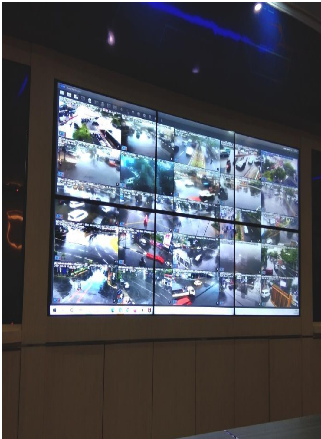
Pantaun CCTV ETLE di Kantor Bagian Back Office ETLE
