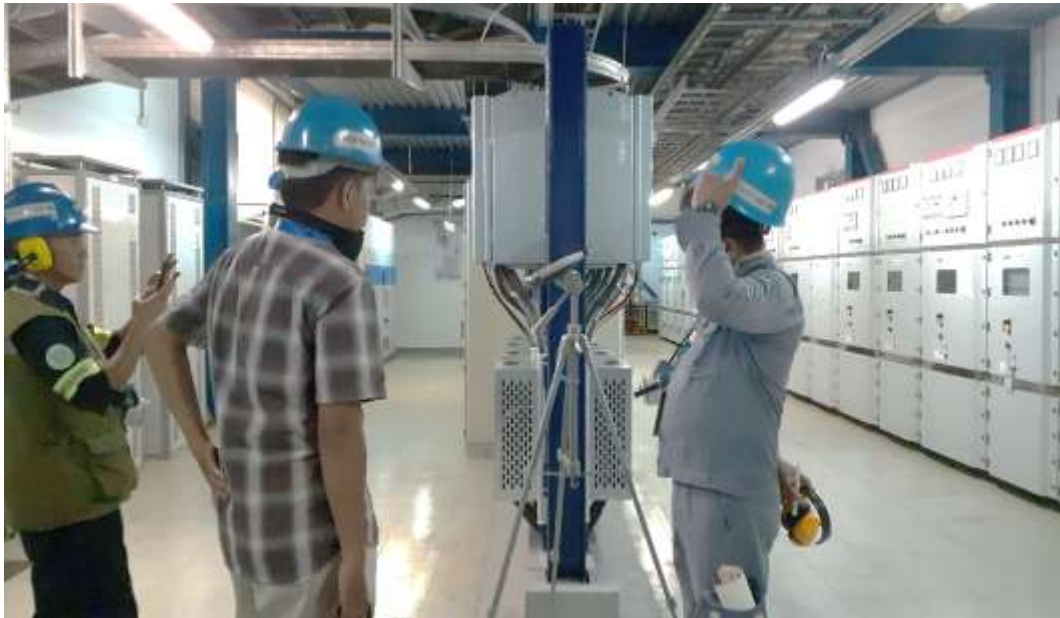
pengukuran kebisingan dan getaran di bagian mesin area diesel power plant
