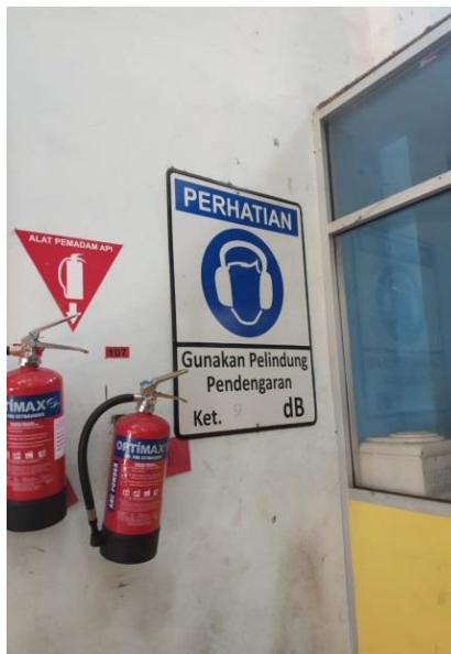
Gambar . APAR 2.6 (Alat Pemadam Api Ringan) Sumber: Data Primer, 2020
