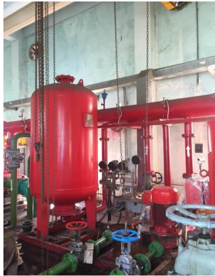
Gambar 2.3 Pompa Pemadam Kebakaran Sumber: Data Primer, 2020
