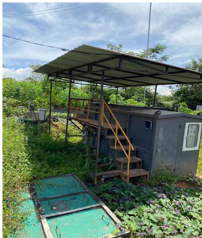
Gambar 12 Instalasi Pengolahan Air Limbah (IPAL)
