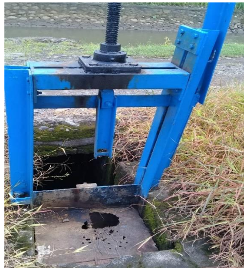
Gambar L-6. Pintu Air yang rusak
