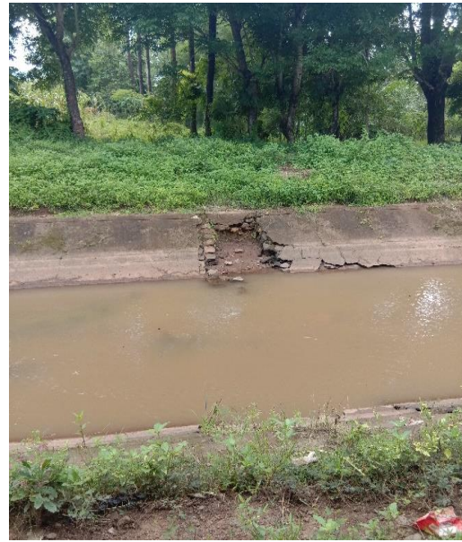
Gambar L-4. Tempat cuci yang rusak
