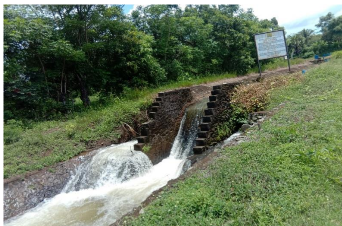
Gambar L-2. Tanggul yang rusak
