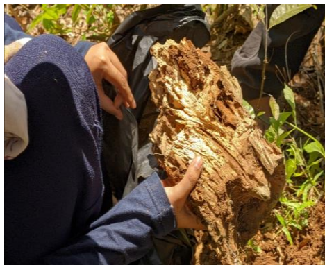
Kayu yang terserang rayap
