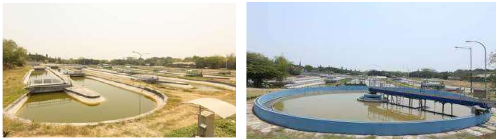
Gambar 3. Instalasi Pengolahan Sekunder
