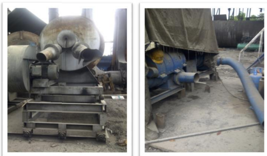
Gambar 5. Burner dan instalasi pembakaran batubara
