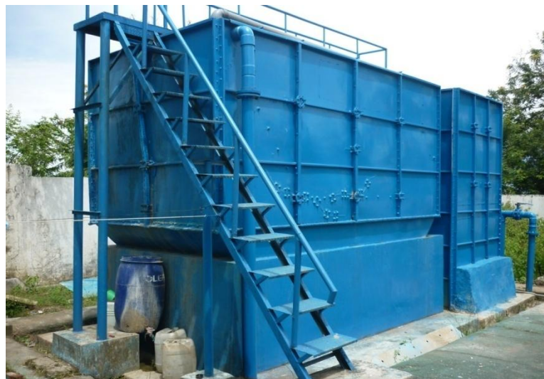
Gambar 2. Bak Penampungan PDAM
