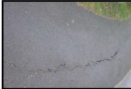
Gambar 2.6 Retak Sambungan Bahu dan Perkerasan
