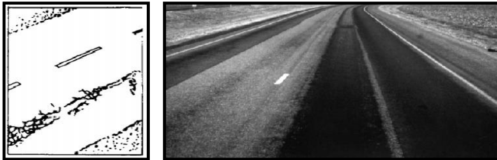
Gambar 2.22 Penurunan pada bekas penanaman utilitas
