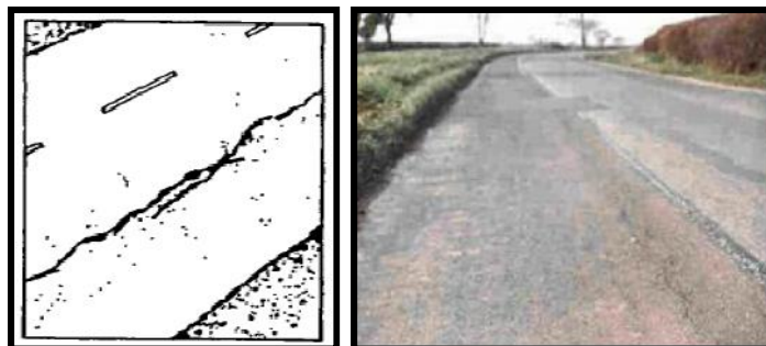
Gambar 2.8 Retak Sambungan Pelebaran Jalan
