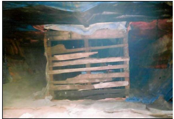
Gambar 10. Kamar Mesin Kapal Pinisi 35 GT (tidak kedap)
