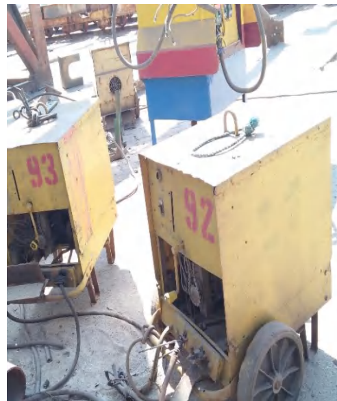
Mesin trafo las
