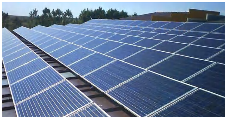
Gambar 2.8 Listrik Tenaga Sinar Matahari
