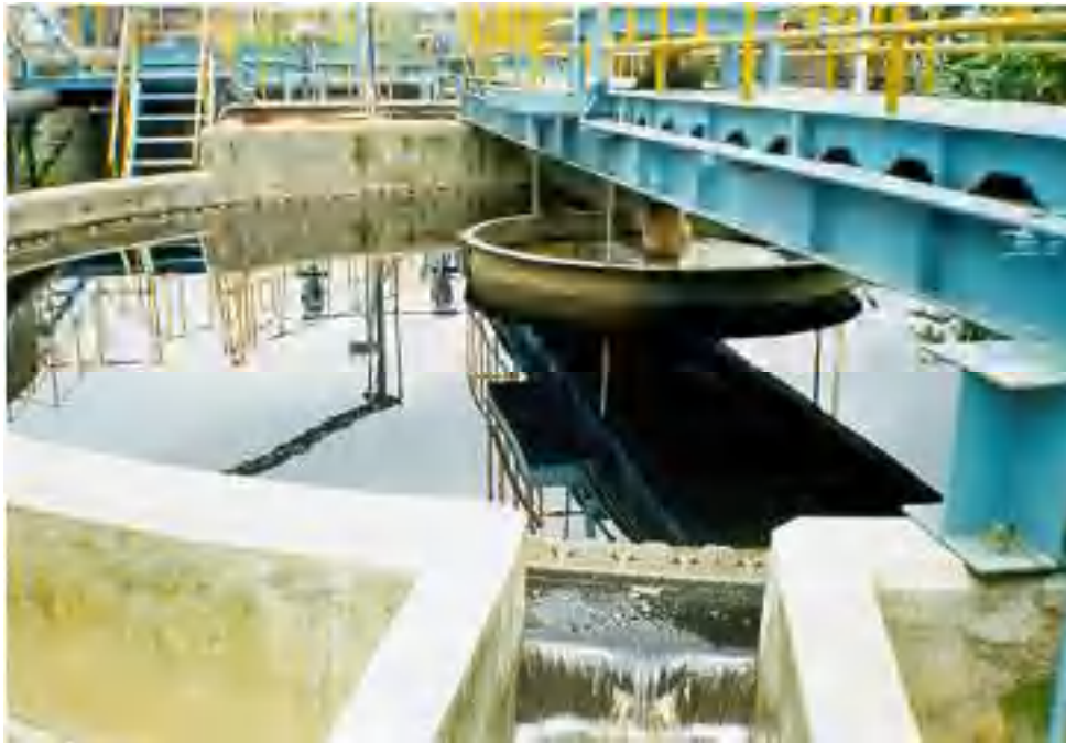
Gambar 2.7 Kondisi Bak Pengendap Akhir
