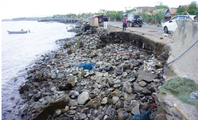
Gambar 7. Kerusakan konstruksi jalan pesisir pantai di Kabupaten Bantaeng (Foto: Arli, 2018)
