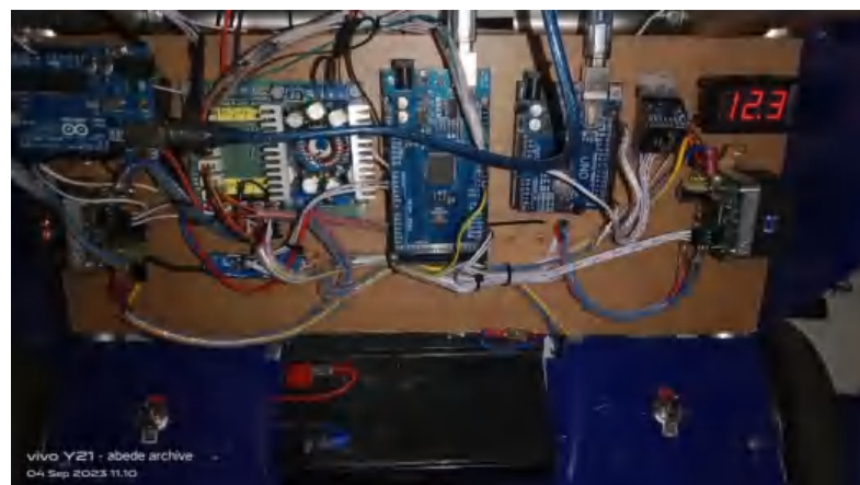
Instalasi perangkat keras Waiter-Bot
