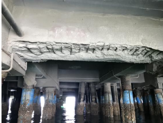
Gambar 3 Beton bertulang mengalami spalling
