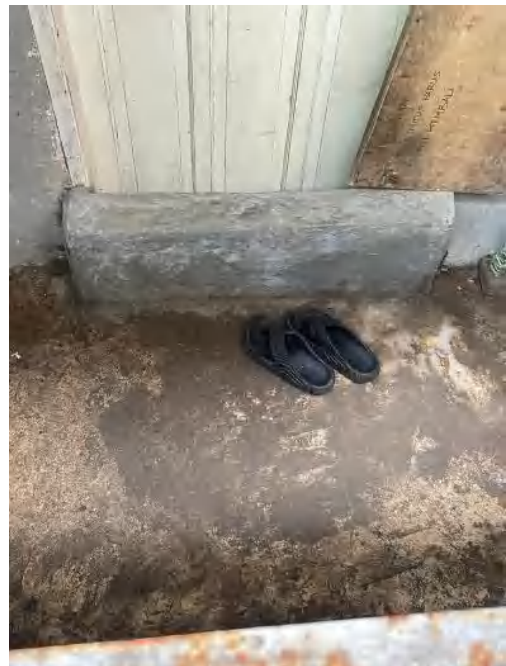
Salah satu beton penahan banjir di depan rumah warga
