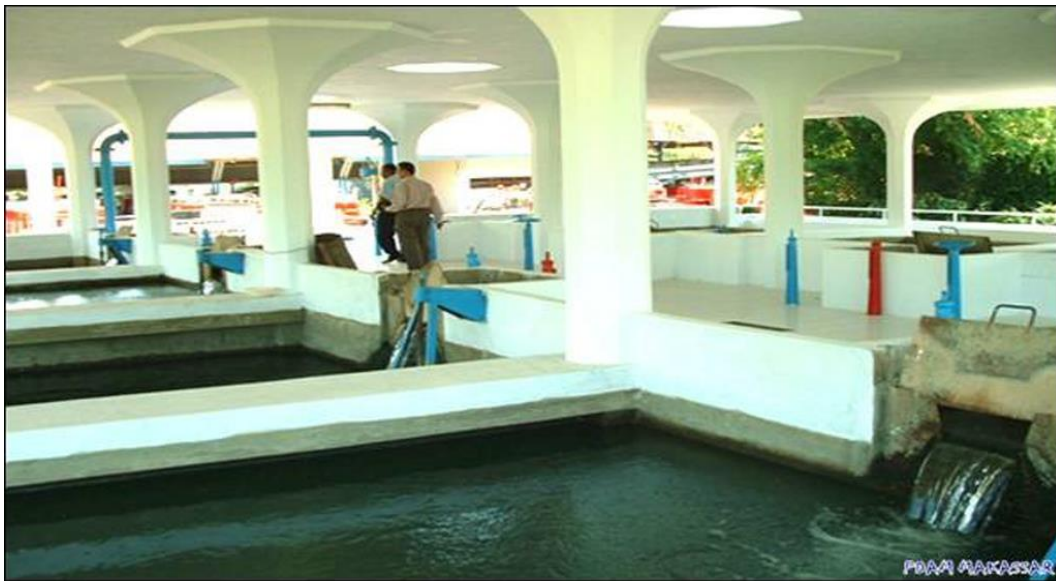
Bak penyimpanan air bersih IPA I Ratulangi
