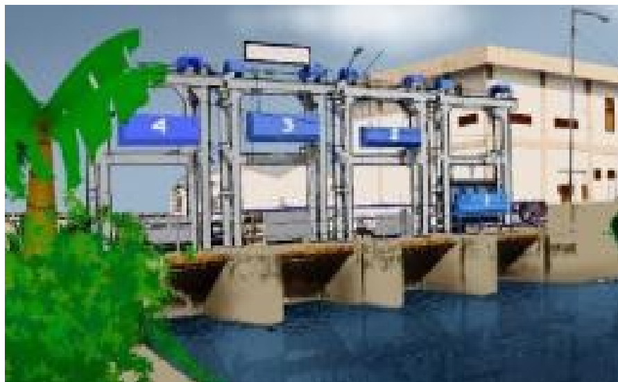
Gambar 17. Pintu Air Elektro Maknetik
