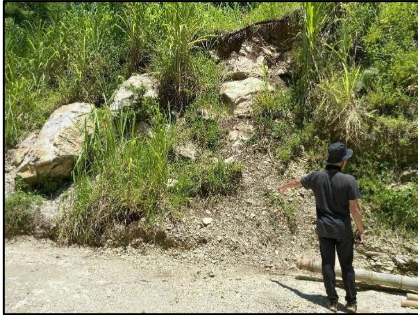
Gambar 22 Debris slide pada stasiun 16 dengan arah pengambilan foto N 12°E
